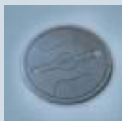
str. 38 Przepust kablowy SG1
